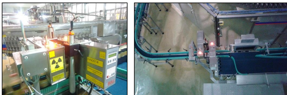
Figura 2: Medidores nucleares para medição de nível em bebidas, empresa 2. Fonte: arquivo pessoal
